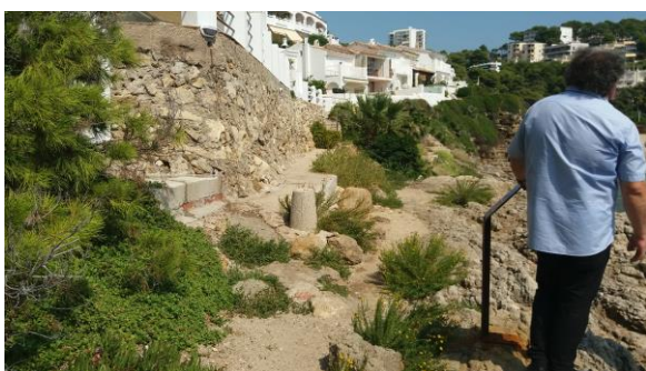
Estretament existent en el punt M-95
